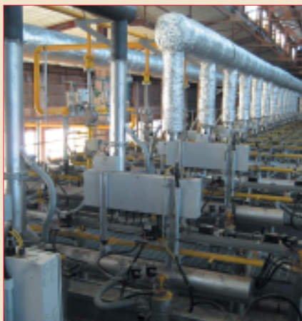
Туннельная печь с газовыми горелками, отапливаемая со свода
