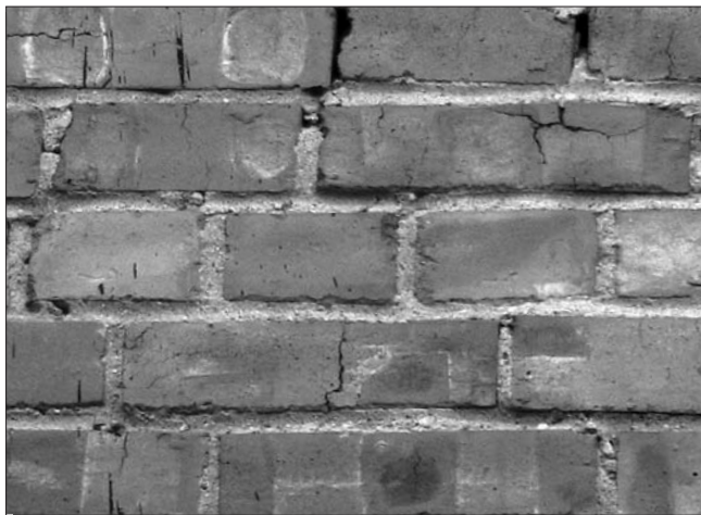
Рис. 1. Образование микротрещин в растворных швах и кирпиче при использовании жестких цементных растворов
