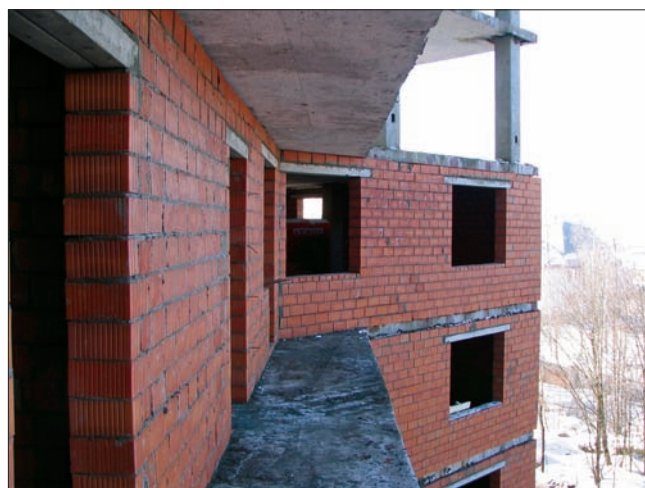
Строительство многоэтажного жилого дома с применением керамического поризованного камня 4,5 НФ производства ОАО «Победа ЛСР»
