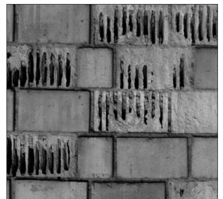
Рис. 3. Фрагмент фасада здания с разрушающимися лицевыми камнями
