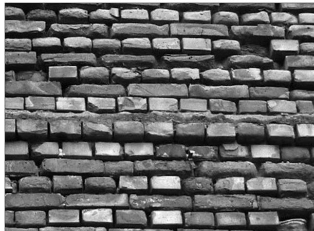
Рис. 2. Пример выкрашивания растворных швов кладки
