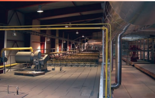
Туннельная печь с установкой горелок на своде
