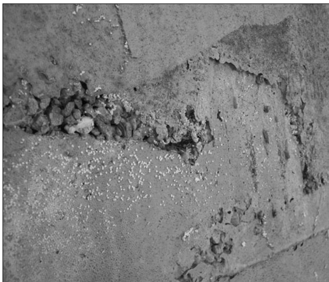
Рис. 3. Расслоение бетона в конструкции
