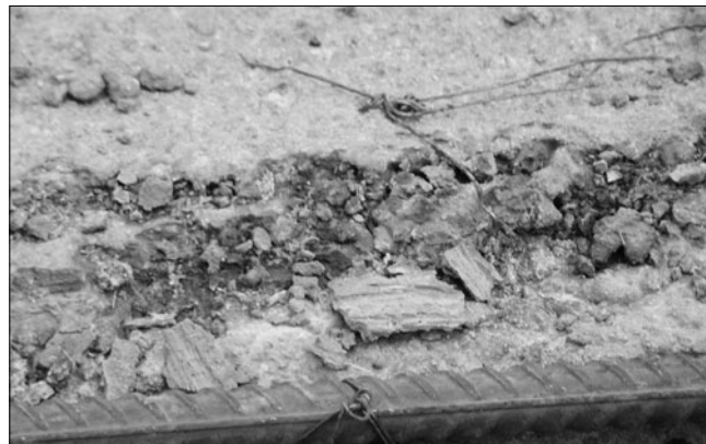
Рис. 1. Фрагмент монолитного железобетонного пандуса с низким качеством выполнения бетонирования
