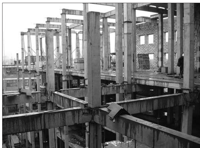
Рис. 4. Возведение несущего каркаса типа Saret из сборных керамзитобетонных элементов (секционных бесстыковых колонн, l = 14–17 м, и ригелей пролетом до 12 м) при строительстве склада готовой продукции химзавода в Казани (2006 г.)
