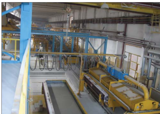
Рис. 1. Технологическая линия по производству автоклавного газобетона на ОАО «Сморгоньсиликатобетон»
