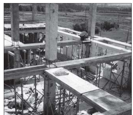
Строительство 9-этажного каркасного сборно-монолитного жилого дома с мансардой по индивидуальному проекту на основе изделий, выпускаемых региональным домостроительным комбинатом
