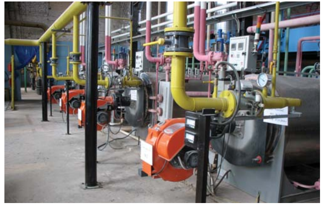
Новые парогенераторные установки
