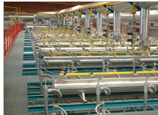
Туннельная печь со сводовыми горелками
