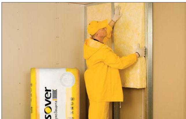
Стеновая конструкция (перегородка) из двух слоев ГКЛ на стальном каркасе с минераловатной теплоизоляцией ISOVER ЗвукоЗащита – 75/Е
