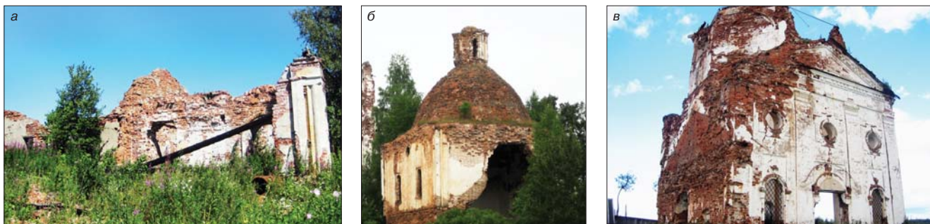
Рис. 1. Преднамеренные разрушения несущих конструкций Белозерского и Кирилловского р-нов: а – Сретенская церковь в с. Поповка (1763 г.); б – Николаевская Островская церковь в д. Ватаманово (1749 г.); в – Петропавловская церковь в с. Петровское (1808 г.)
