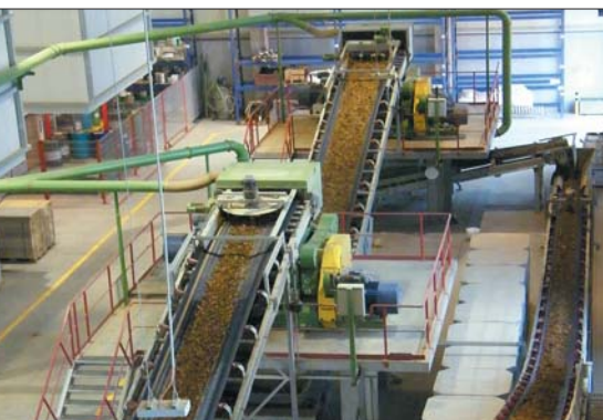
Двухступенчатая линия по измельчению с двумя конструктивно идентичными валковыми дробилками «Титан» 1000 × 1000 М, а также с транспортером к круглому шихтозапаснику
