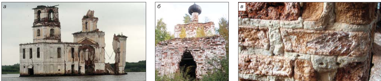
Рис. 3. Виды разрушений и повреждений кирпичной кладки: а – разрушение конструкций в результате изменения гидрогеологических условий (Христорождественская церковь Крохинского погоста, 1820 г.); б – разрушение поверхностных слоев кирпичной кладки в результате морозного выветривания (Введенская церковь в с. Лохта, 1779 г.); в – солевая коррозия кладки в результате переувлажнения конструкций (Троицкая церковь в с. Улома, 1807 г.)
