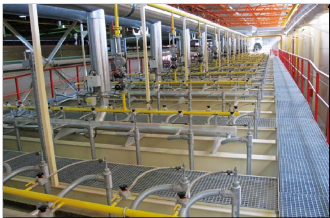
Сводовые горелки в зоне обжига печи
