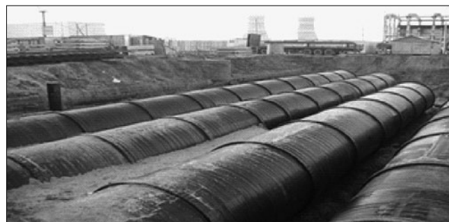
Рис. 4. Трубопроводы подачи воды. Калининская АЭС, 2008 г.
