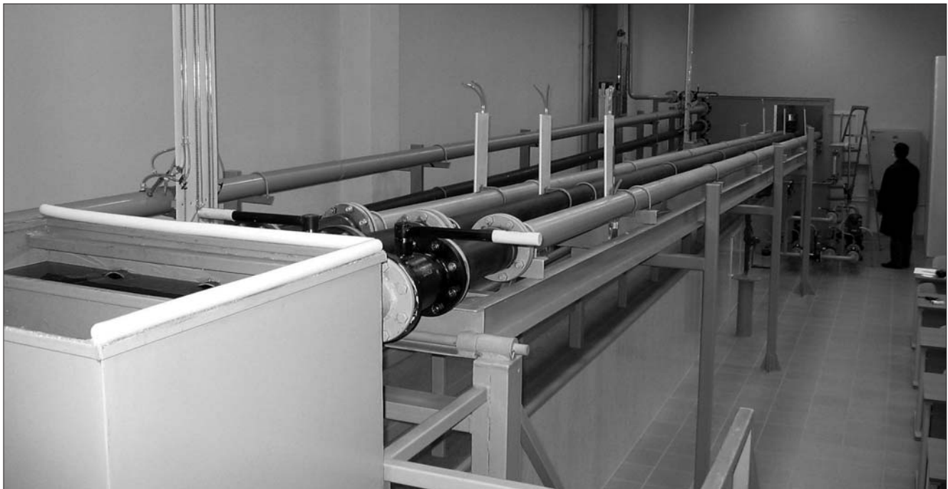
Общий вид гидравлического стенда со стороны накопительных емкостей
