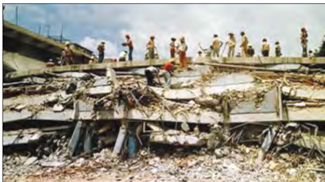
Рис. 2. Примеры разрушения конструкций (землетрясение в Мексике 19 сентября 1985 г.)
