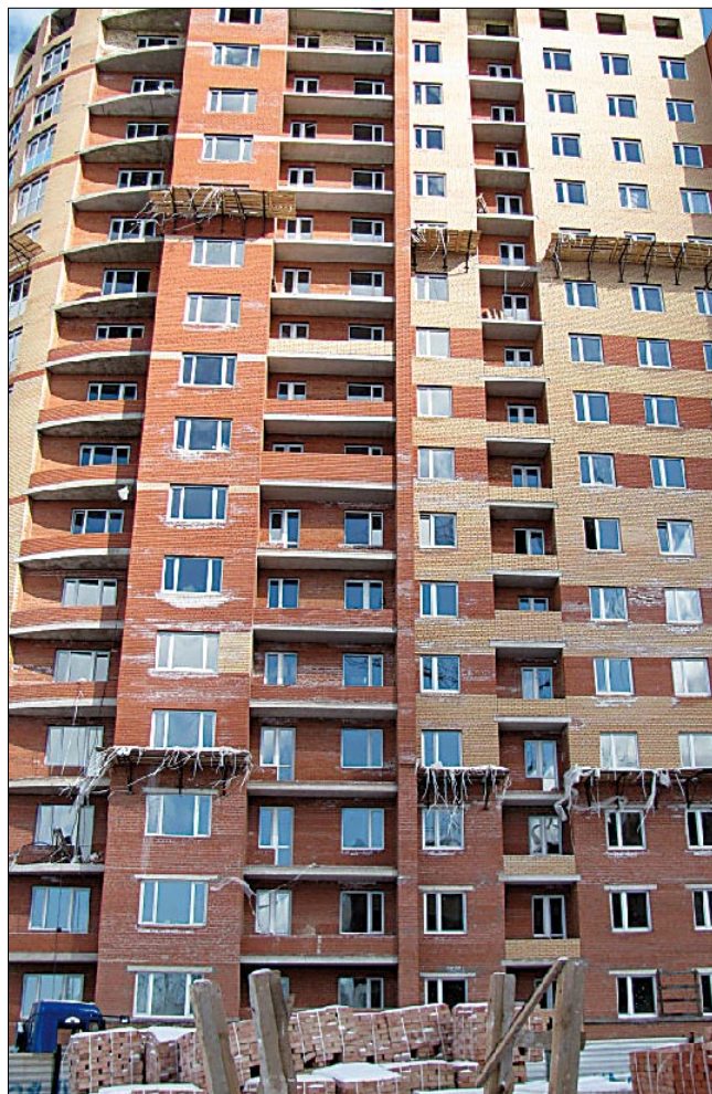
Рис. 7. Высолообразование по фасаду дома на 27.03.2011 г.
