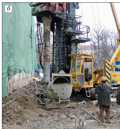
Рис. 1. Устройство свай по технологии Fundex: а – общий вид установки; б – изготовление свай у межевой стены соседнего дома
