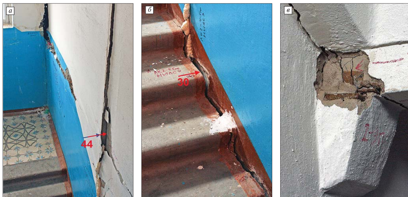
Рис. 2. а — смещение стеновых панелей на 44 мм; б — зазор между стеновой панелью и лестничным маршем 30 мм; в — наклонные трещины в опорной зоне несущего продольного ребра лестничной площадки
