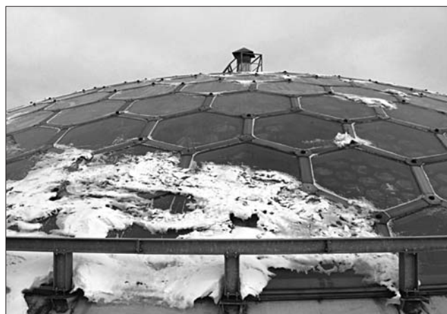
Рис. 5. Распределение снежного покрова на поверхности стеклянного купола административного здания МИД РФ на ул. Новый Арбат в Москве
