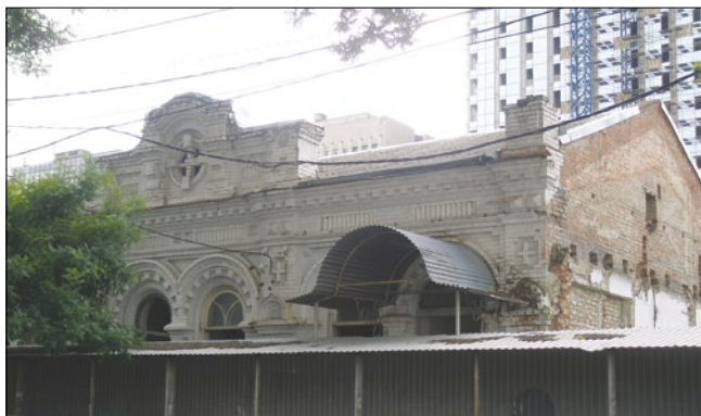
Рис. 6. Фрагмент верхней части жилого дома начала XX в., угол ул. Красноармейской и ул. Длинной (здание практически разрушается из-за производимых вблизи строительных работ)
