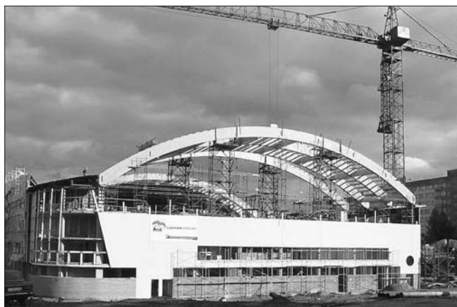
Рис. 1. Монтаж клеедеревянных арок пролетом 48 м на этапе строительства первой очереди спортивного комплекса «Буртасы»
