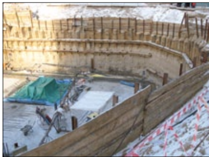
Рис. 9. Отсутствие элементов крепления ограждения котлована (по проекту шаг распорных конструкций составлял ~4–6 м)
