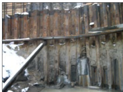
Рис. 6. Деформации распределительной балки из-за отсутствия ее сопряжения с подкосом
