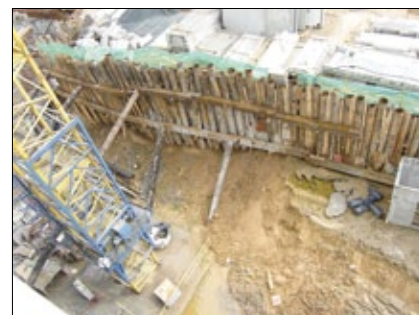
Рис. 8. Неудовлетворительное качество конструкций ограждения
