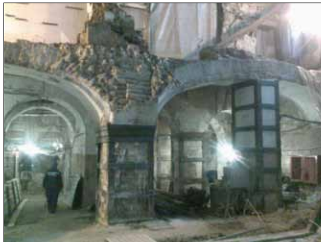
Рис. 1. Аварийные колонны по оси Д1 из известняка, усиленные стальными обоймами
