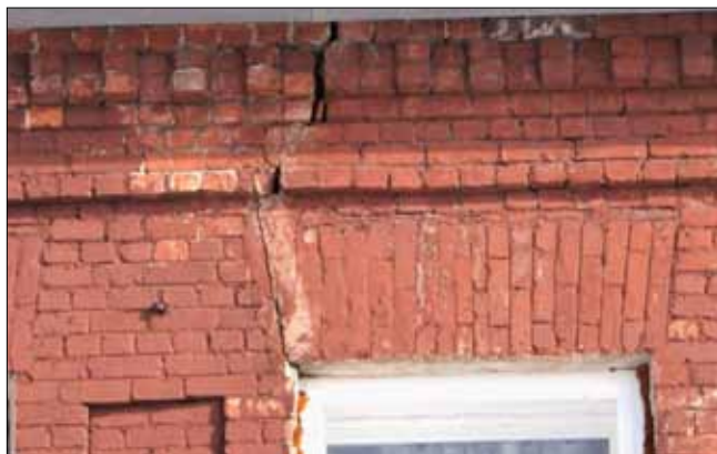
Рис. 5. Трещина в наружной стене в кирпичной перемычке над дверным проемом (выход на балкон) второго этажа. Ширина раскрытия трещины в нижней части (ранее заделанной) до 8,5 мм, в верхней части — до 26 мм (в 2006 г. низ — 5 мм, верх — 20 мм)
