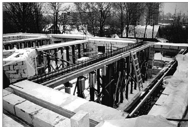
Рис. 2. Строительство 5-этажного жилого дома с неполным каркасом и комплексным применением автоклавного ячеистого бетона (Смоленск, РФ)
