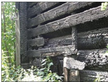
Рис. 3. Фрагмент обгоревшего дома
