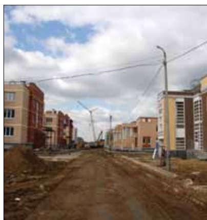
Жилой комплекс «Сакраменто» в г. Балашиха Московской обл., застраиваемый малоэтажными крупнопанельными домами
