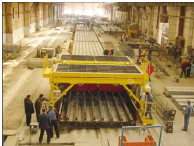
Универсальный вибробетонукладчик с поворотным бункером на испытании по выпуску свай на универсальном стенде l = 108 м. ОАО «Монолитстрой». ЗАО «Рекон». 2010 г.
