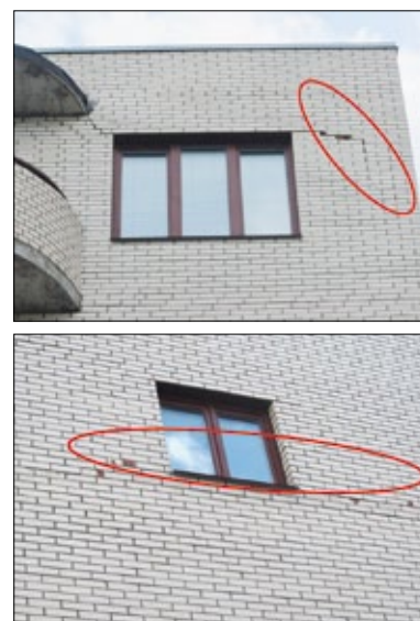
Рис. 8. Вертикальные и горизонтальные трещины в ограждающих конструкциях
