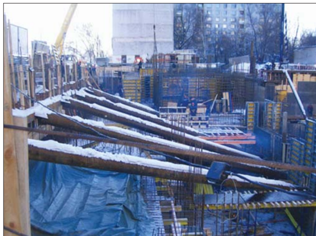
Рис. 11. Возведение конструкций нулевого цикла. Демонтирована распорная система II яруса. Монолитные работы выполнялись ЗАО «Первый строительный трест», Москва
