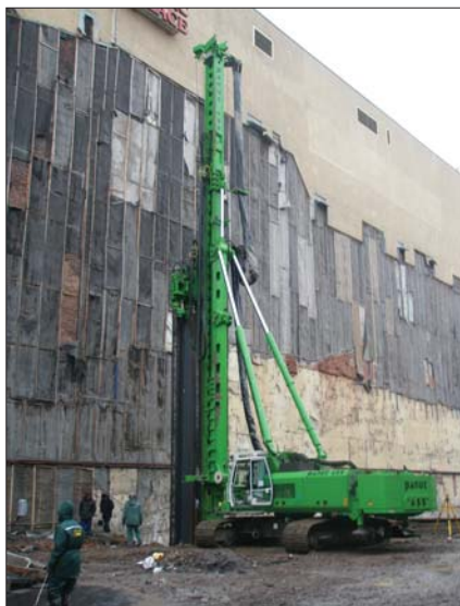
Рис. 4. Устройство ограждения котлована вдавливанием металлического шпунта при строительстве офисного комплекса гостиницы «Невский палас»
