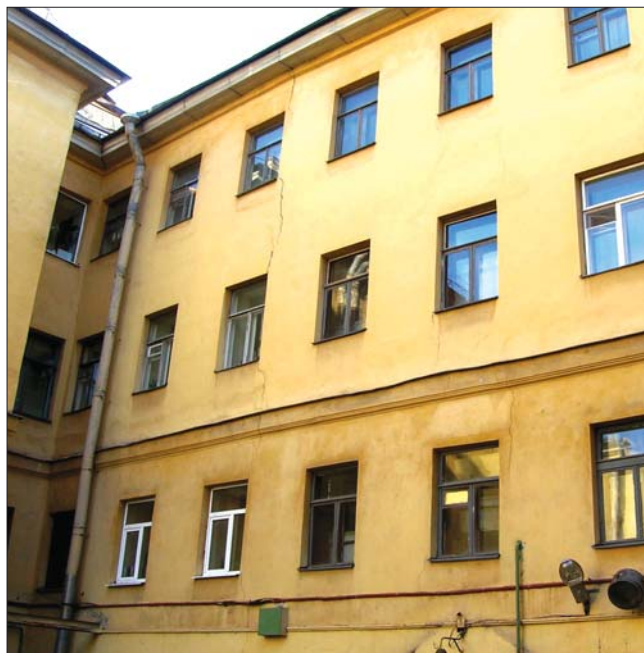
Рис. 2. Трещины в стенах дворового фасада д. 3 по ул. Союза Печатников
