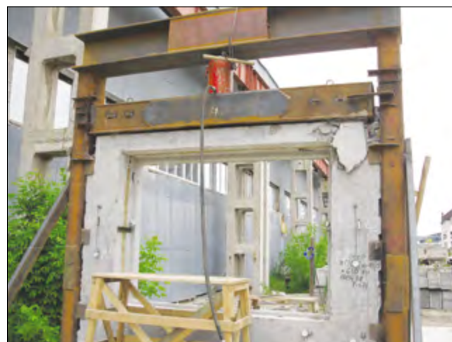
Рис. 6. Локальное разрушение простенка
