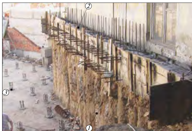
Рис. 2. Фрагмент узла включения существующего трехэтажного здания в единый технологический цикл с вновь застраиваемым объектом: 1 – ограждение котлована из буронабивных свай ЭРТ; 2 – монолитный железобетонный обвязочный пояс; 3 – буронабивные сваи ЭРТ свайного поля
