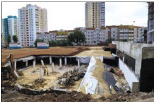
Рис. 2. Общий вид обрушения здания подземной стоянки жилого комплекса в г. Белгороде
