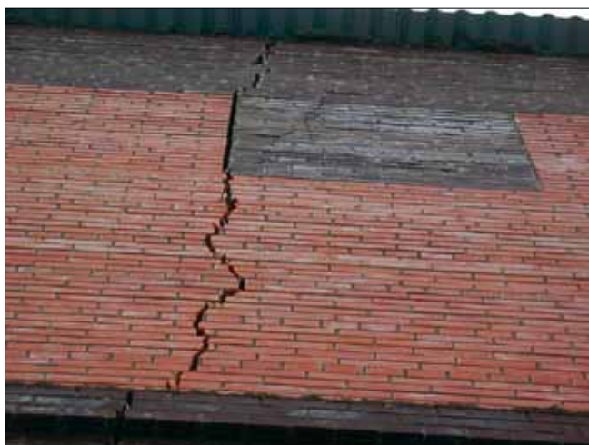
Рис. 1. Сквозные трещины в стенах здания
