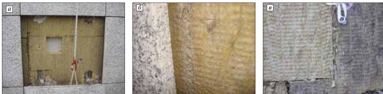
Рис. 3. Поверхность плит утеплителя после вскрытия гранитных плит ветфасада: а – внешний вид; б – поверхность плит утеплителя под зазором между плитами гранитной обшивки; в – загрязнение плит утеплителя
