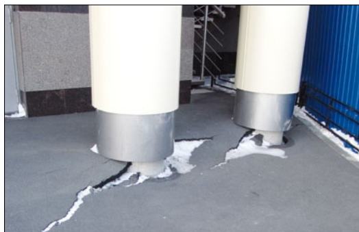
Рис. 3. Просадка асфальтового покрытия у колонн соседнего дома \approx 200 мм
