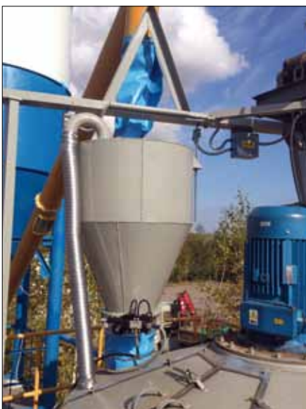
Рис. 3. Система дозирования цемента
