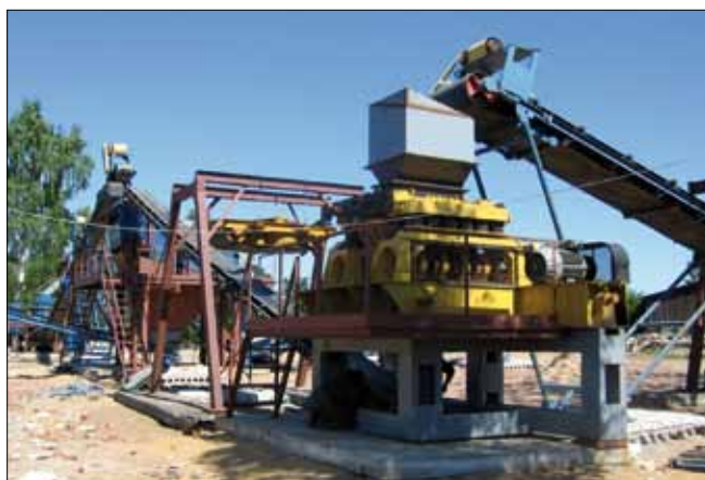
Рис. 2. Общий вид установки для дробления строительных отходов
