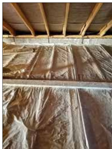
Рис. 2. Разрушение структуры и оседание минераловатных матов утепления чердачного перекрытия жилого дома в Уфе после 12 лет эксплуатации
