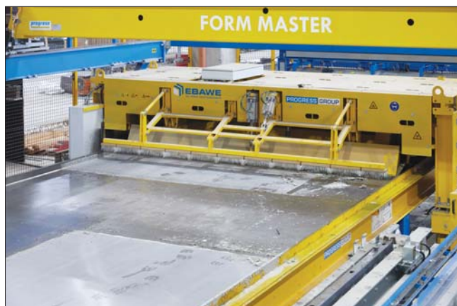
В новой линии циркуляции паллет на заводе HTB Hoch- und Tiefbaustoffe GmbH & Co. KG в г. Кённерн поверхность паллет после распалубки оптимально очищается устройством чистки паллет
